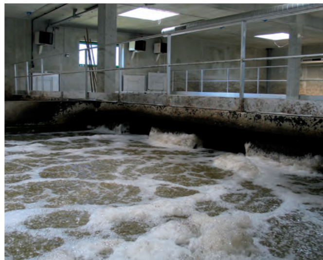
L'unité biologique de la station d'épuration du SYSEG permet de dépolluer les eaux usées à 95 % avant leur rejet dans le Rhône. Les bactéries naturellement présentes dans le fleuve se chargent de la dépollution des 5 % restant.
